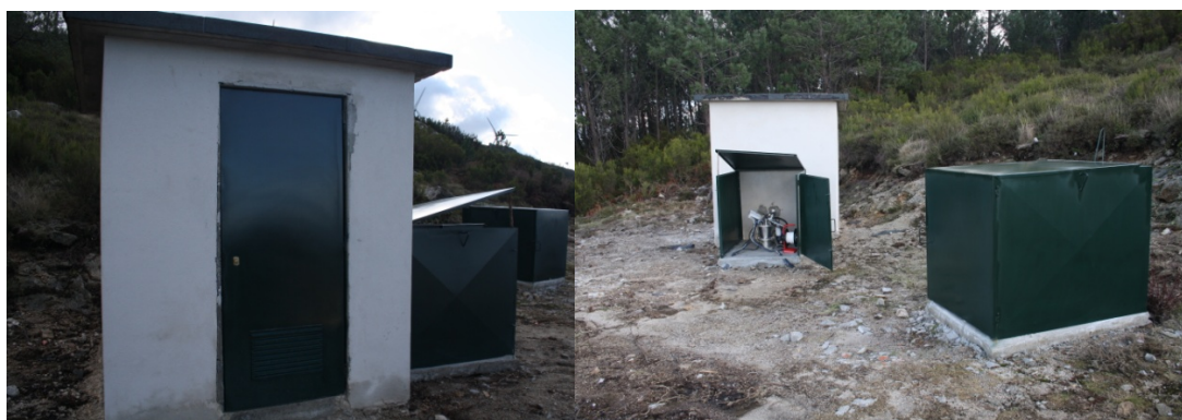
Figura 3 – Exemplo de um sistema de protecção de uma captação com casa de manobra e controlo (quadro eléctrico) independente da captação (fotos gentilmente cedidas por UNICER ÁGUAS, SA)
